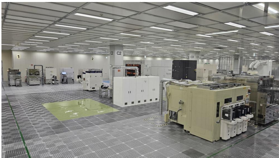
ルネサスエレクトロニクス甲府工場内のクリーンルーム（2024年4月撮影）
